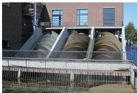
図 11 スクリュー式のポンプ 1分間に1,350 m 3 の水の揚水が可能である。 (2011年9月筆者撮影)
